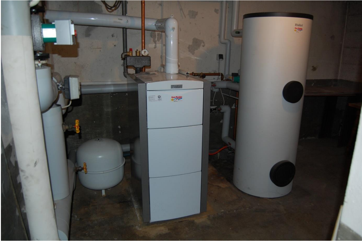
Abbildung 14: Ein relativ moderner Gas-Brennwert-Kessel mit Pufferspeicher in einem Mehrfamilienhaus in der Breslauer Straße
