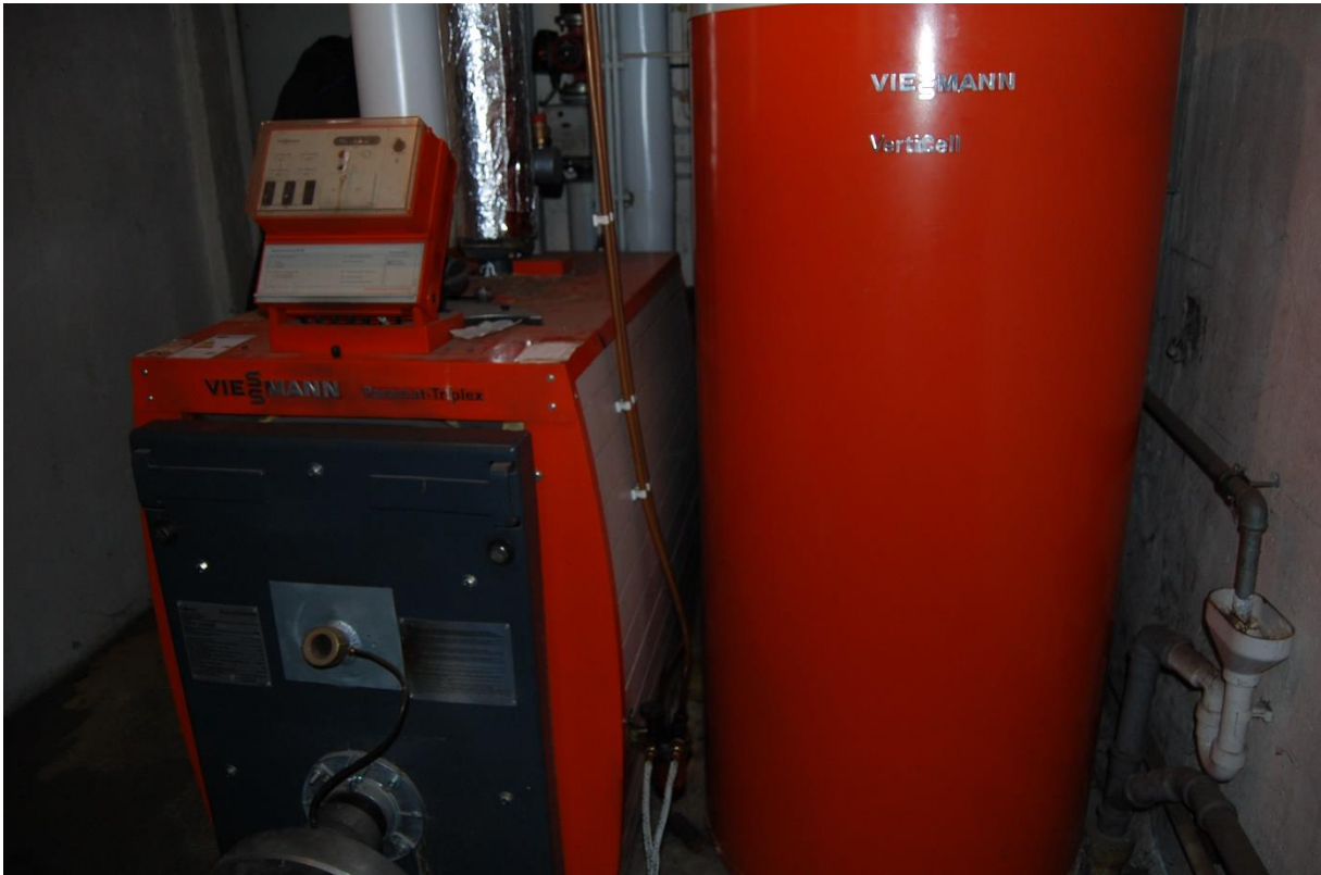
Abbildung 15: Ein in die Jahre gekommener Gas-Heizkessel mit Pufferspeicher in einem Mehrfamilienhaus in der Kantstraße
