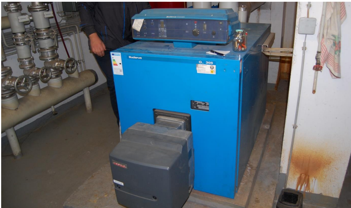
Abbildung 17: Ein bald austauschpflichtiger Öl-Heizkessel in einem Mehrfamilienhaus in der Breslauer Straße mit 130 kW Leistung
