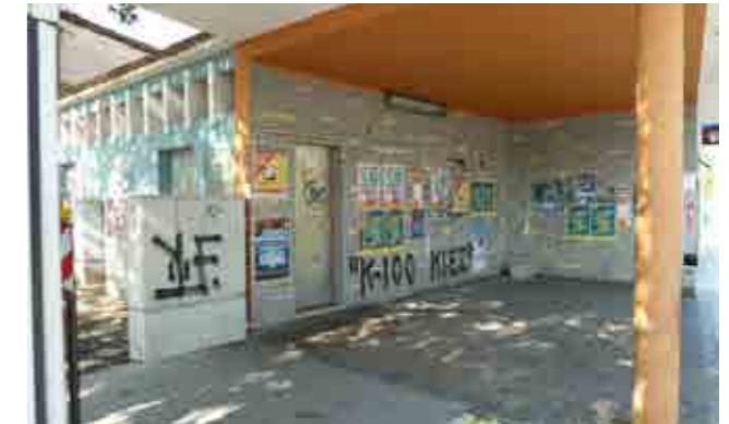
Abb. 29: Gebäudemängel Ecke Hauptstraße / Klybeckstraße
